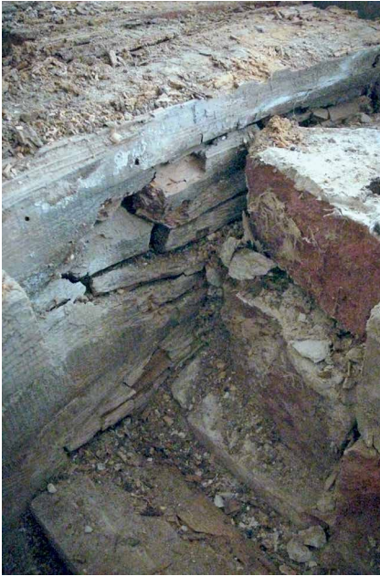
Abb. 5: Braunfäule an Deckenbalken
