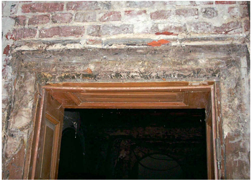
Abb. 6: Schwammbefall am Türsturz
