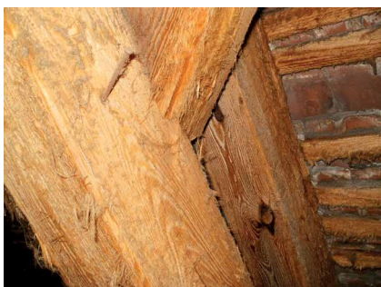
Abb. 5: Mazeration am Dachtragwerk
